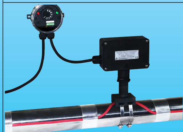
Beispiel für die Montage an zwei Begleitheizungskabeln, in Kombination mit Y29 Anschlusskasten
